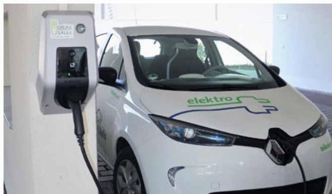
Abb. 8 Wand-Ladestation für den zukünftigen Elektrofahrzeugpool der CSg
